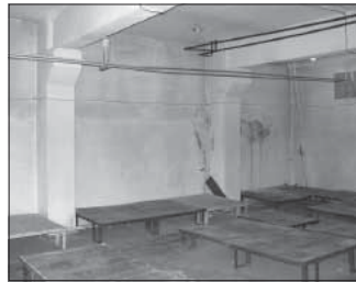
Просп. Ленина, 125 (склад). Общая площадь 498,8 кв.м.
