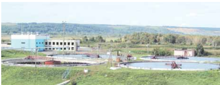
На фото: сооружения первичных отстойников ОСК, где происходит механическая очистка стоков от оседающих и плавающих примесей.
